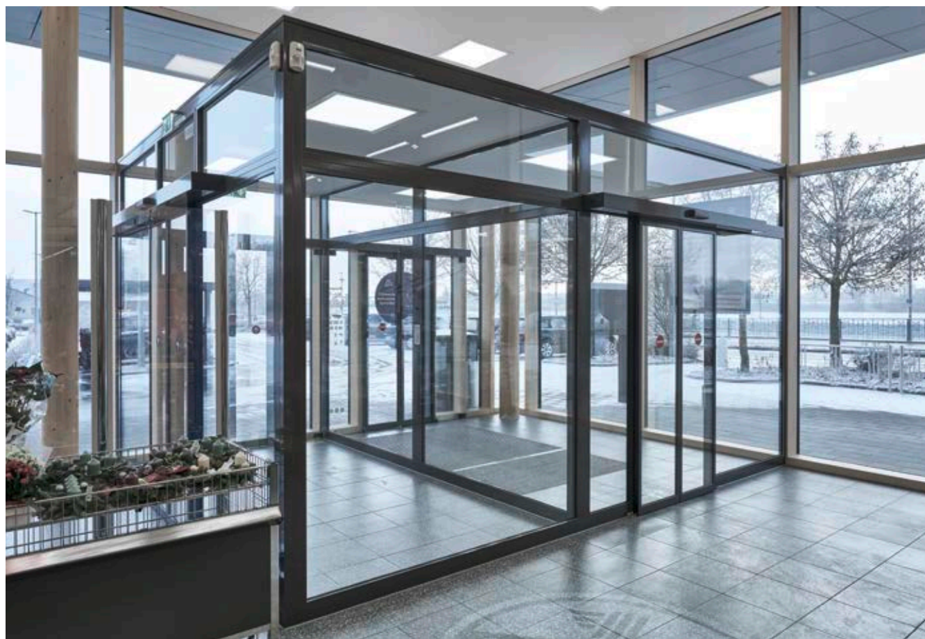
Automatisme de portes coulissantes automatiques ECdrive T2-FR, Aldi Süd – filiale de Mühldorf (photo : Robert Sprang / GEZE GmbH)
